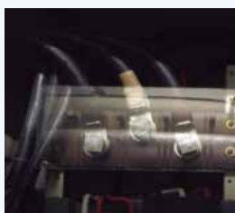
配線異常發熱
