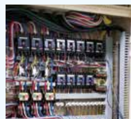
控制盤內機器異常發熱
